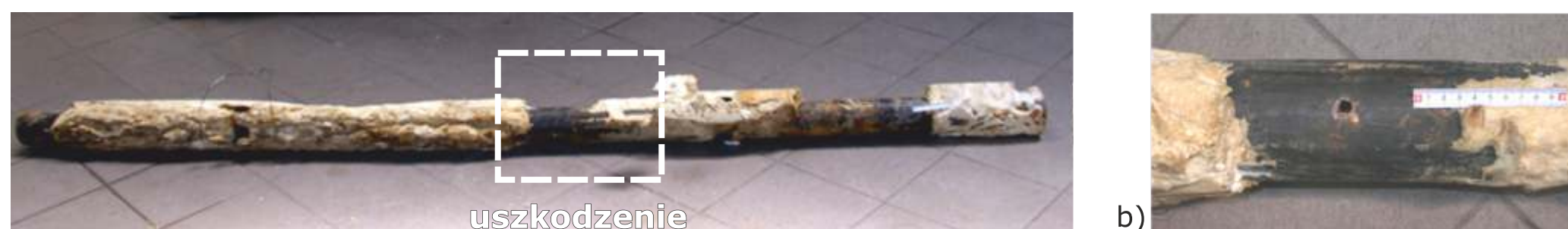
Rys. 1. Fragment rurociągu DN 80 (a), widoczne uszkodzenie ścianki rury (b)
