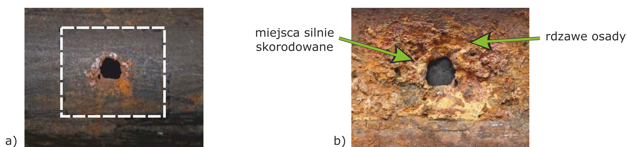
Rys. 2. Uszkodzenie rurociągu DN 80 widok zewnętrzny (a), widok od strony wnętrza rury (b)
